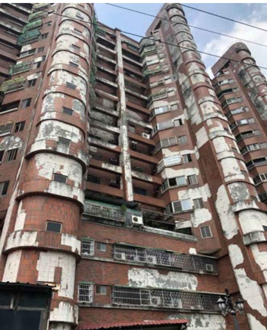
外牆磁磚剝落嚴重
